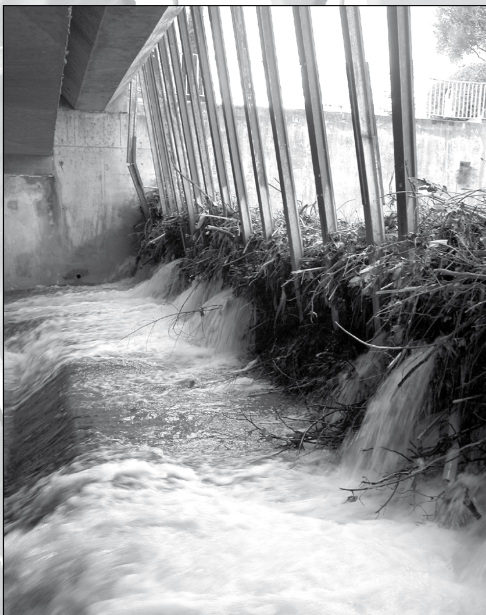
Drégrilleur à l'entrée de la partie couverte de la rivière neuve.
