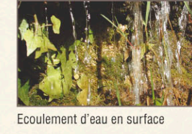
Ecoulement d'eau en surface
